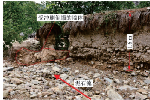
图3 冲刷倒塌的墙体
